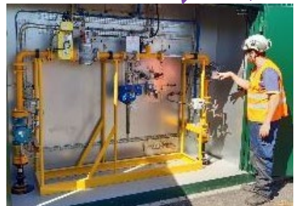
Injection au réseau de gaz naturel
