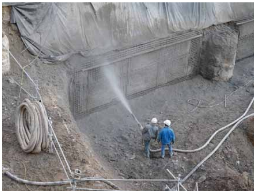
Respect de la sécurité sur le chantier - Pôle des langues et civilisations / Paris (75)
