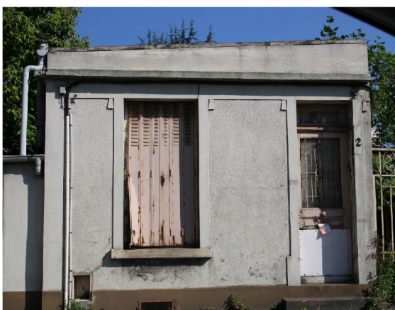
Habitat dégradé à La Courneuve
