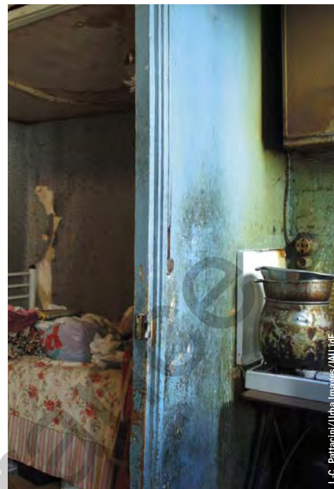
Certains logements ne remplissent pas les fonctions fondamentales de sécurité et santé des occupants.
