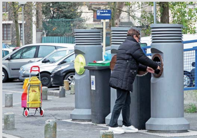
Collecte pneumatique des déchets à Romainville
