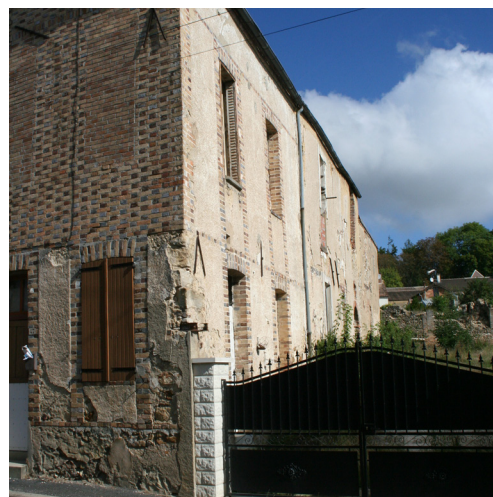
Façade en briques en mauvais état
