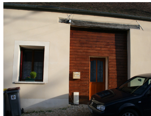
Une petite porte moderne à simple battant, enchâssée dans l'ancienne structure remplacée par du bardage, a succédé à la porte cochère dont le linteau est laissé apparent alors qu'il devrait rester protégé. L'enduit ajouté sur la façade n'est lui non plus pas adapté au modèle traditionnel
