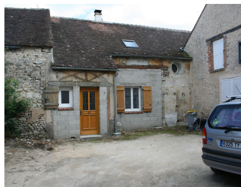
Mauvais état d'entretien d'une maison transformée avec de nouveaux ouvrants et des parpaings laissés apparents
