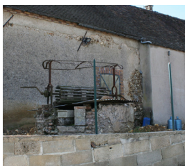
Puits en très mauvais état dû à sa perte de fonction
