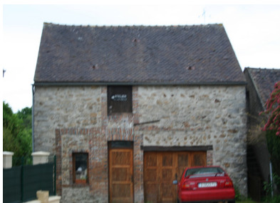
Ancien petit bloc qui, bien qu'ayant conservé son gabarit a perdu beaucoup de son authenticité par les deux portes et la fenêtre du rez-de-chaussée réduites alors que les anciens entourages de briques sont restés en place. L'ancienne gerbière a elle aussi été transformée.
