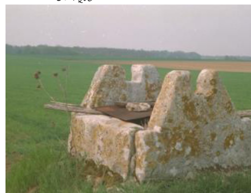
Puits à mitre ayant perdu sa toiture au Petit Creilly commune de Lorrez-le-Bocage-
