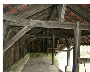
A Bazoche-sur-le-Betz, le treuil permettant d'actionner le plancher mobile est encore très visible... malgré la disparition du plancher ce qui rend l'édifice peu compréhensible.
