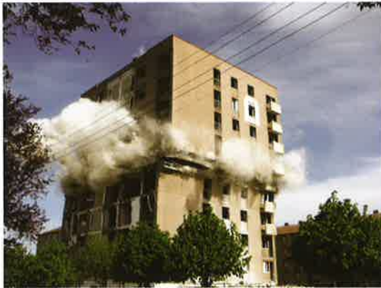
La poursuite des objectifs de renouvellement urbain : la démolition de la Tour Miellet dans le quartier de l'Arsoit. © OPDHLM 90
