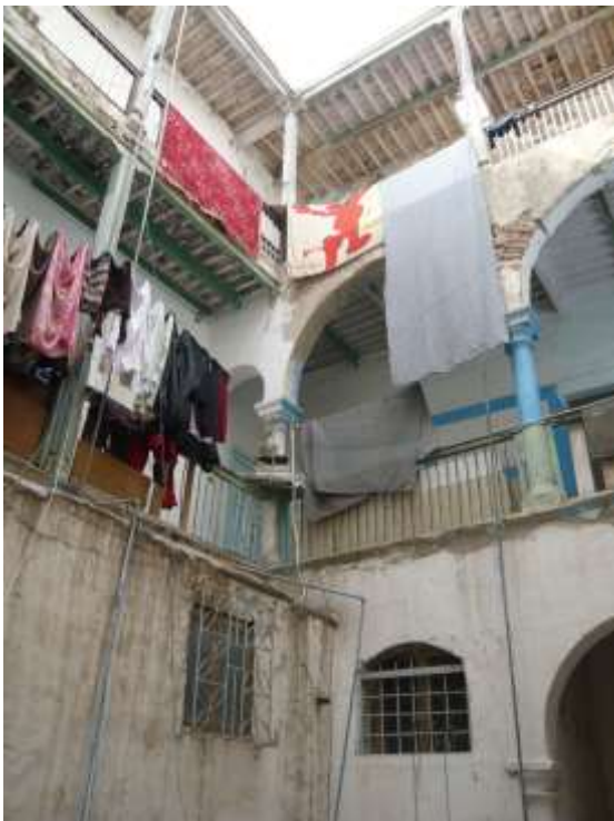
Patrimoine architectural nécessitant restauration.
