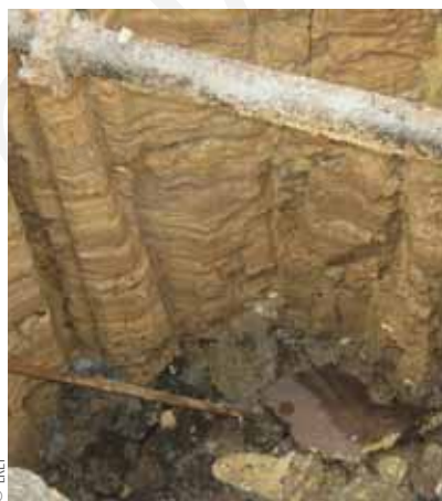
Phénomène de dissolution du gypse suite à une rupture de canalisation.
