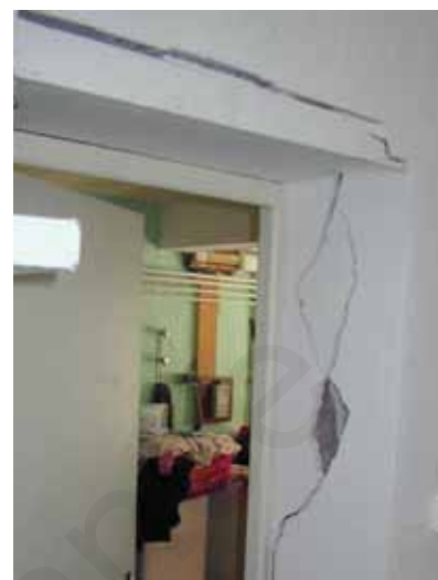
Fissuration affectant une propriété suite à un phénomène de retrait-gonflement.
