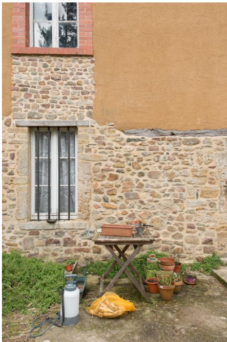
Avant les travaux les murs de la maison de Thérèse étaient dégradés par l'humidité, autant à l'extérieur qu'à l'intérieur.
