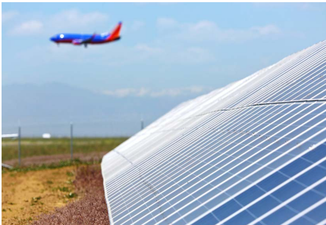
Panneaux photovoltaïques, Aéroport de Denver Source: Aéroport international de Denver
