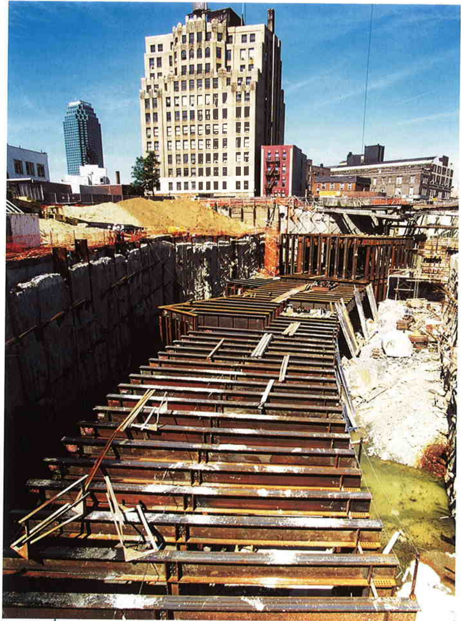
Le 63 rd Street Queens Boulevard Connector sur le point d'être couvert avec en arrière-plan des immeubles de la ville de Long Island.
