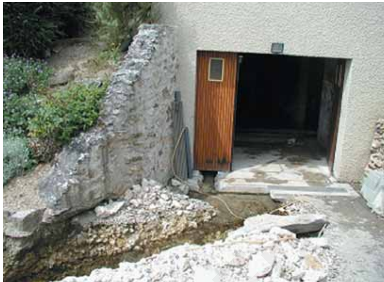
Inondation d'un sous-sol provoquée par la remontée de la nappe du Calcaire de Champigny à l'est de Provins.
