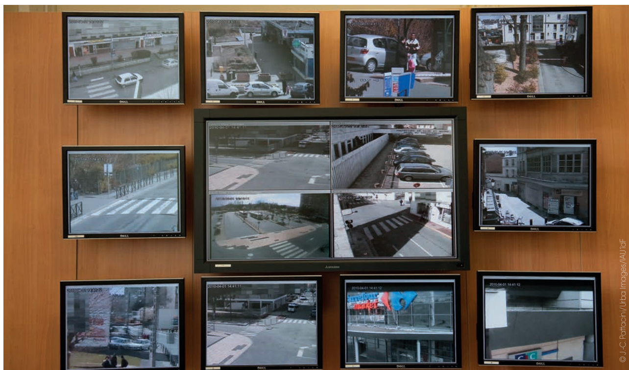
• Poste de surveillance vidéo
