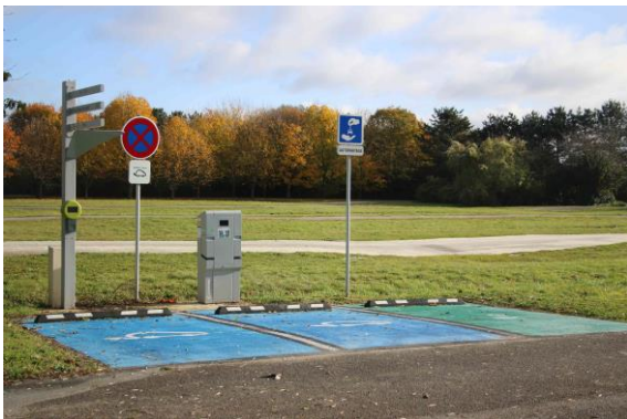
Borne de recharge à l'île de loisirs de Jablines-Annet © IAU îdF
