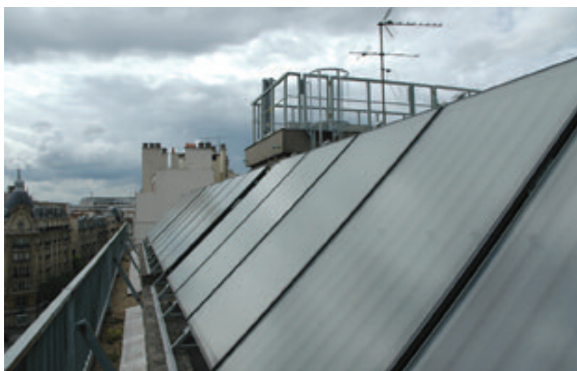
60 m 2 de panneaux solaires pour trente logements, rue Letellier, Paris XIV e . Le solaire assure 40 % des besoins énergétiques pour l'eau chaude sanitaire. Réduction des émissions de CO 2 = 353 T/an.
