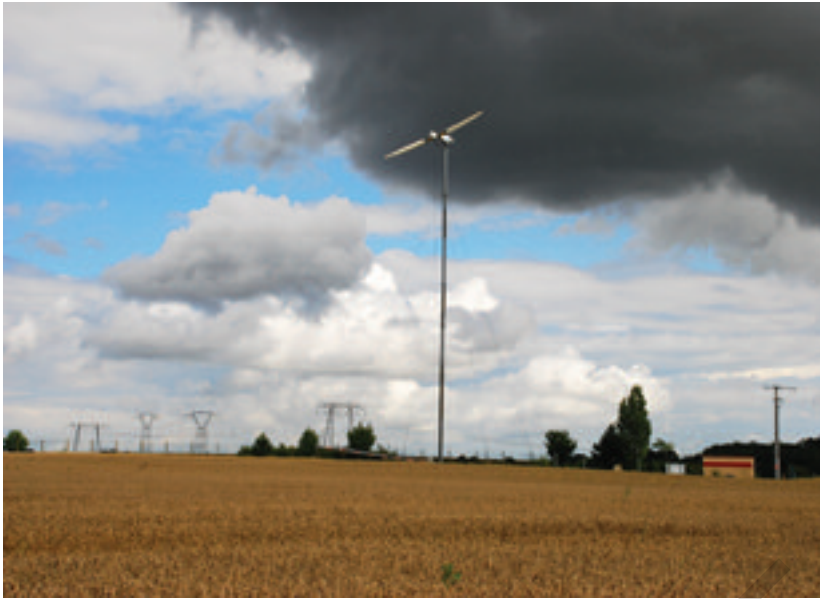
Éolienne de 6,5 kilowatts alimentant le centre de stockage de déchets ultimes, Guitrancourt, Yvelines.
