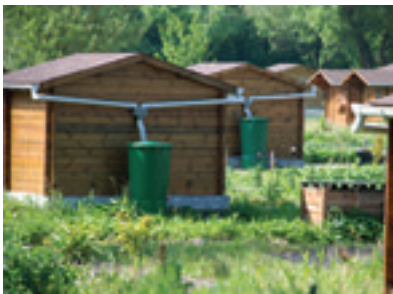
Jardins ouvriers avec récupération d'eau pluviale, Base de loisirs, Etampes.
