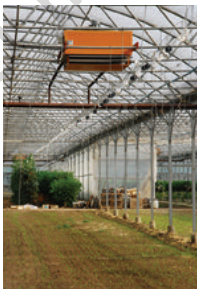
Les cultures sous serres, un nouveau modèle de chauffage à eau chaude, Cergy, Val-d'Oise.
