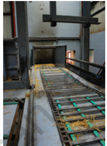
Trémie d'alimentation du four de la chaufferie à paille de céréales (1 600 kw), alimentant 250 logements HLM (1 155 t/an de CO 2 d'origine fossile évité), Villeparisis, Val-de-Marne.
