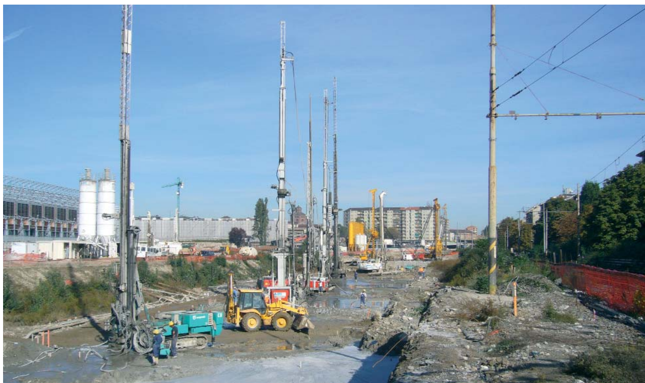
L'enterrement des voies ferrées dans un caisson a permis d'envisager l'aménagement des friches industrielles situées de part et d'autre de l'axe. Ici, les travaux à Spina 3, septembre 2006.
