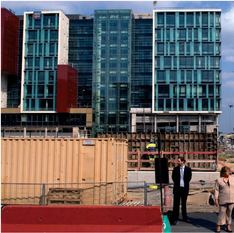
Le projet Seine Arche (Nanterre, Île-de-France) : réparer un territoire détruit par les infrastructures routières.
