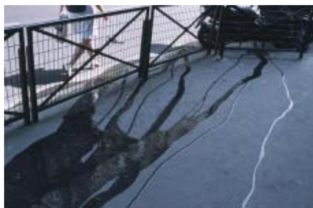
© M. Lacombe – IAURIF – Coulées d'eaux usées sur un trottoir
