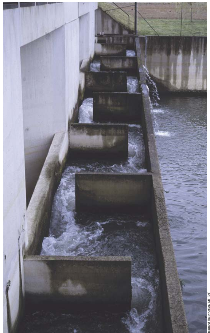
Une passe permet le franchissement des poissons migrateurs, mais pas forcément celui de toute la faune associée aux rivières. La Seine à Thomery (77).
