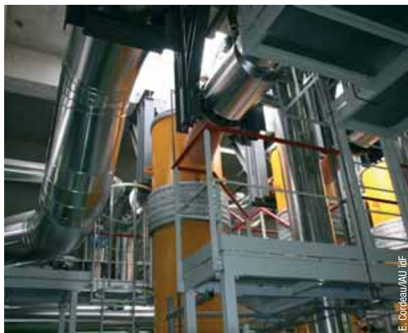
La station d'échange du chauffage urbain de Vitry-sur-Seine
