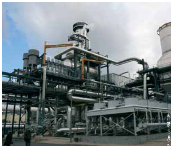
La centrale de cogénération de Vitry-sur-Seine
