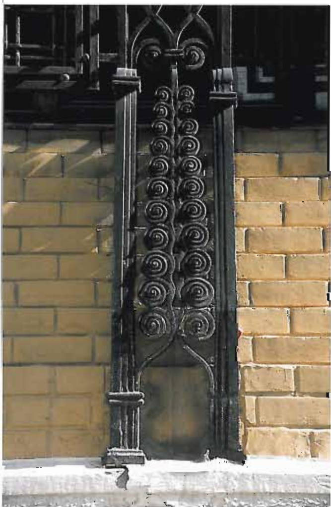
Central téléphonique «Provence», rue Bergère à Paris X, détail des ferronneries de la façade : le patrimoine des XIX e et XX e siècles représente près de la moitié des bâtiments protégés chaque année en France. "Provence" telephone exchange, rue Bergère in the 9th district of Paris. Detail of the ironwork on the facade. 19th and 20th century heritage now accounts for nearly half of the buildings protected in France every year.
