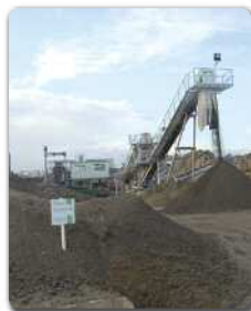
Installation de recyclage Yprema à Gennevilliers (92). M. Bourgeois/IAU idF
