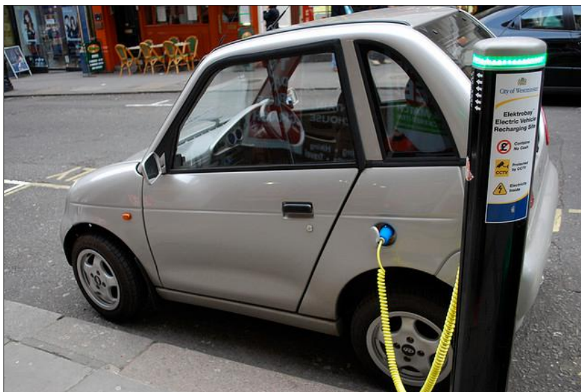
Borne de rechargement en service
