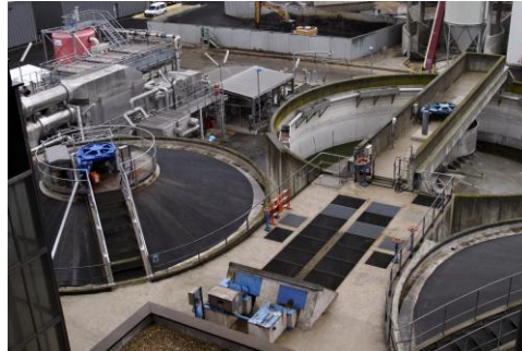
Station d'épuration du Siaap à Valenton (94). Crédit photo : E. Conquy / NoManzland - IAU îdF
