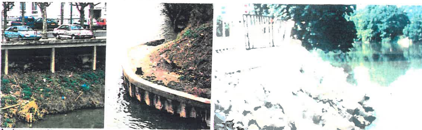
Aménagements sans cohérence avec la nature des berges, zones de rejet
