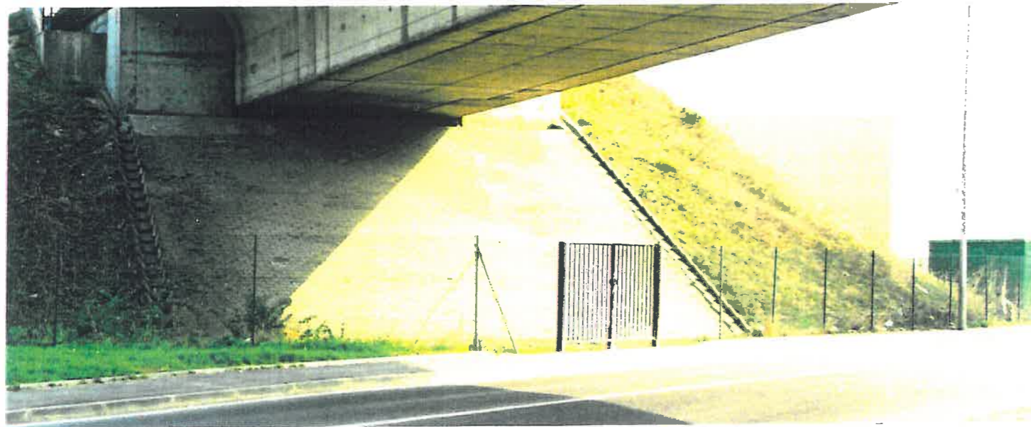
Problème identifié: clôture en pied de remblai coupant l'unité de l'espace
