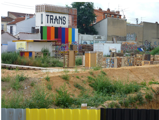
Atelier TRANS 305 en cours de construction à Ivry-sur-Seine Stefan Shankland, Raumlaborberlin Crédit photo : Paul Lecroart – IAU îdF
